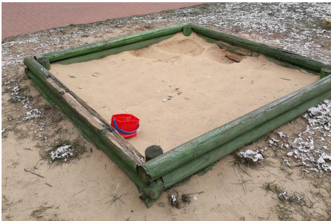
USZKODZONE BELKI DREWNIANE
