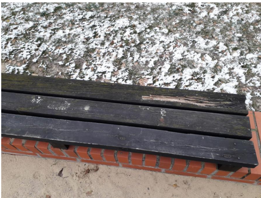
USZKODZONE DESKI ŁAWECZEK
